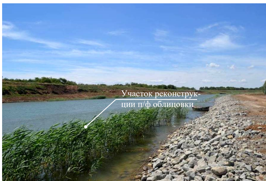
Рисунок 6.8 – Зарастание камышом поверх комбинированной противофильтрационной облицовки
