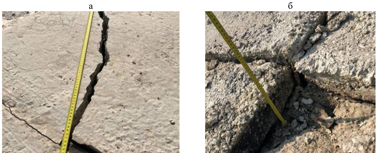
Рисунок 6.25 – Трещины и сколы на бетонном покрытии облицовки: а – трещина на бетонном защитном покрытии; б – сколы на бетонной облицовке
