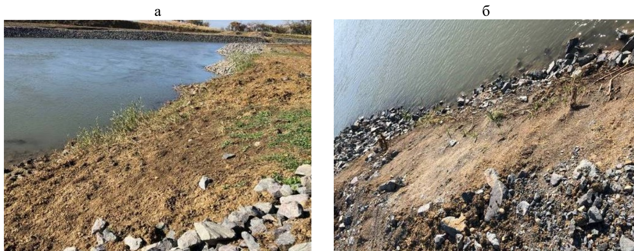
Рисунок 6.22 – Оползание защитных покрытий на участках канала: а – состояние грунтового откоса (ПК 450+30); б – смещение камня на ПК 66+62
