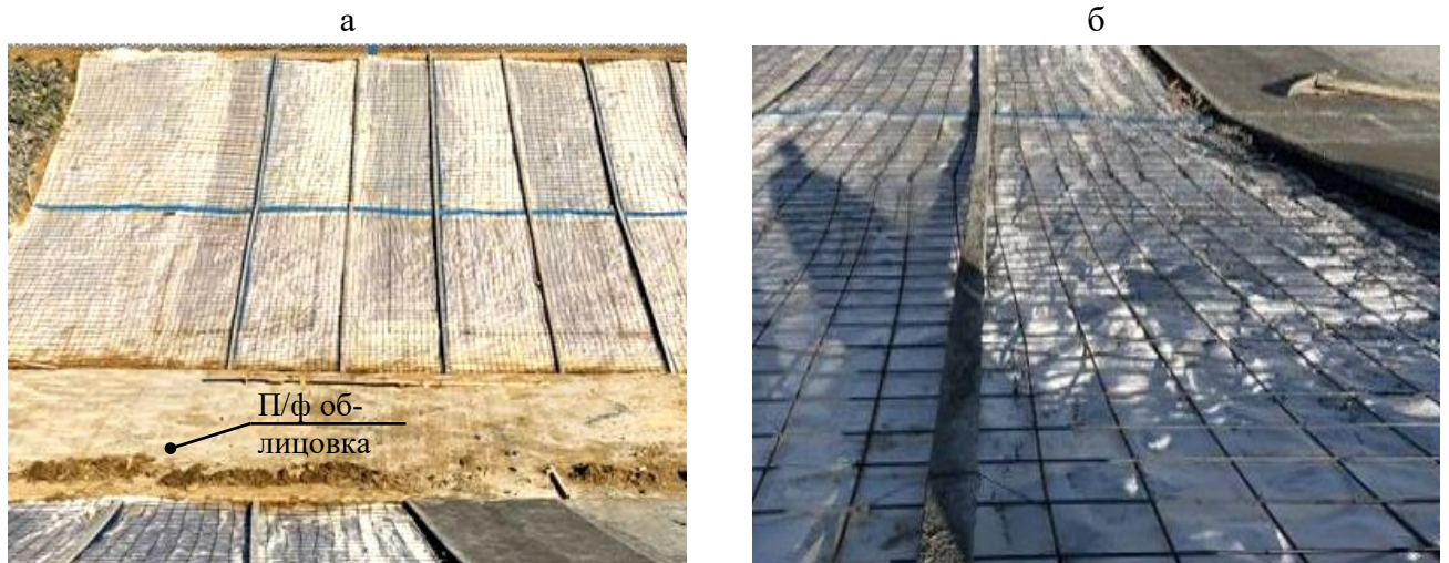
Рисунок 6.26 – Участок незавершенного строительства противодиффузионной облицовки на участке канала: устройство экрана на верховом (а) и низовом (б) откосах
